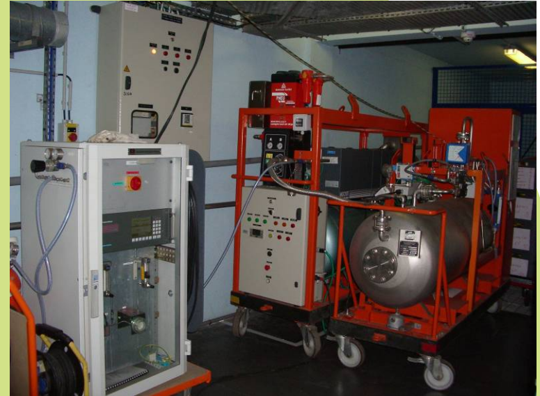
Centrale autonome de production d'air respirable
