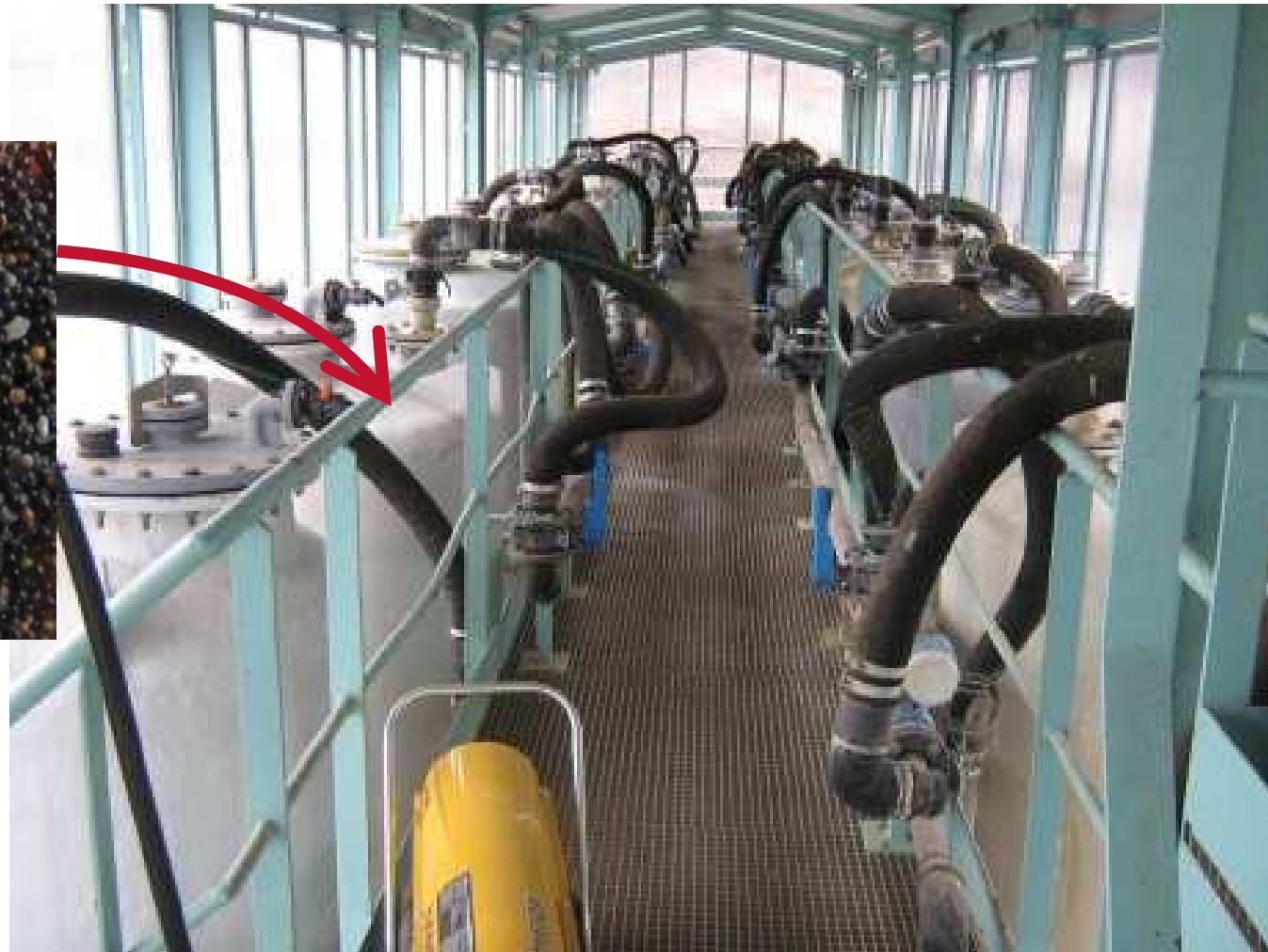
Station de traitement des eaux de Lodève (34)
